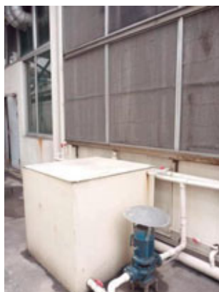
気化式冷風扇を取り付けた窓と循環水タンク
