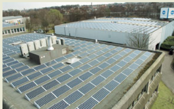
社屋の屋根全面に設置した太陽光発電設備
