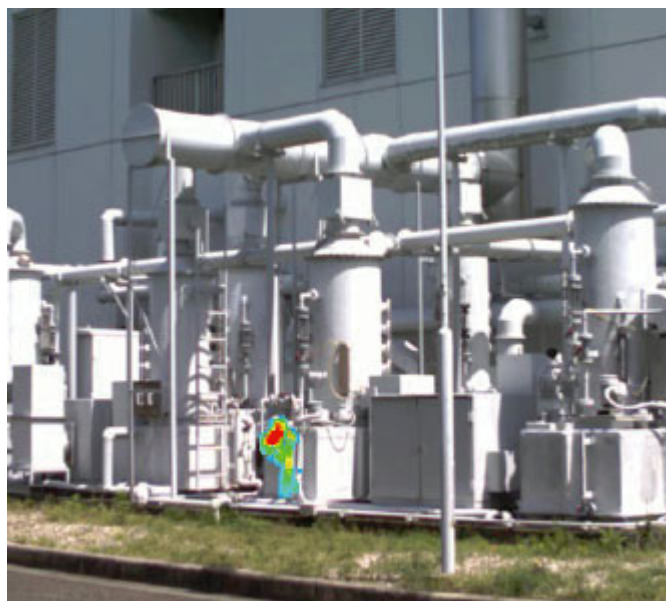
ガス監視ソリューションによるガス漏洩の可視化
