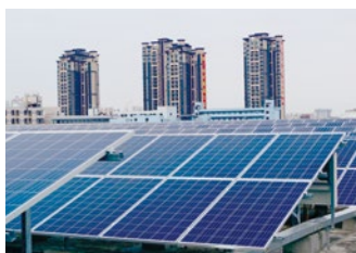
屋上に取りつけられた太陽光発電パネル群
