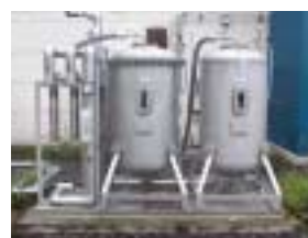
東京サイト八王子の地下水浄化装置
