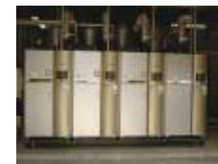
天然ガスボイラー
